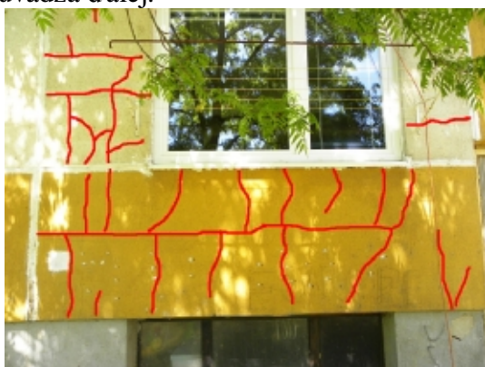
Obr. 2: Trhliny v obvodom plášti T08B NA
