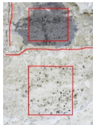
Obr. 11: Identifikované dve rôzne bázy pórobetónu v skladbe panela
