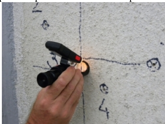
Obr. 4: Meranie šírky trhliny mikroskopom
