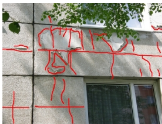
Obr. 3: Trhliny v obvodom plášti PS 82 TT
