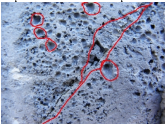
Obr. 10: Trhlina a póry v OPP T08B KE
