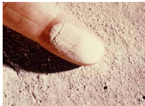
Obr. 6: Prášivosť povrchu betónu
