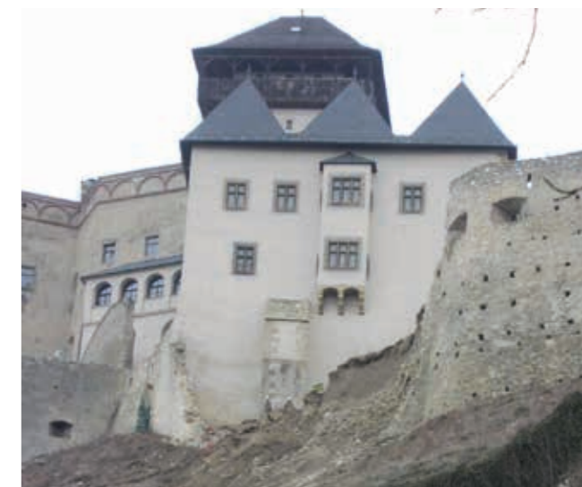
■ Posúdenie príčin zrútenia západného opevnenia hradu Trenčín / Assessing causes of the Trenčín Castle west wall collapse
