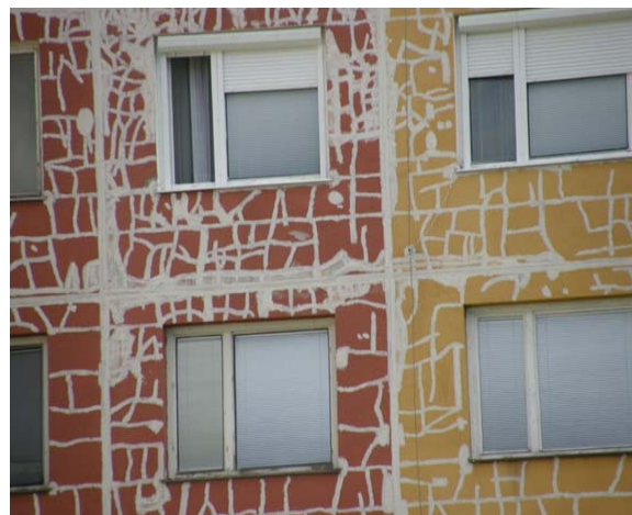
Obrázok 2: Prejavy systémovej poruchy na obvodovom plášt'i hrúbky 300 mm (napr. P 1.15)
