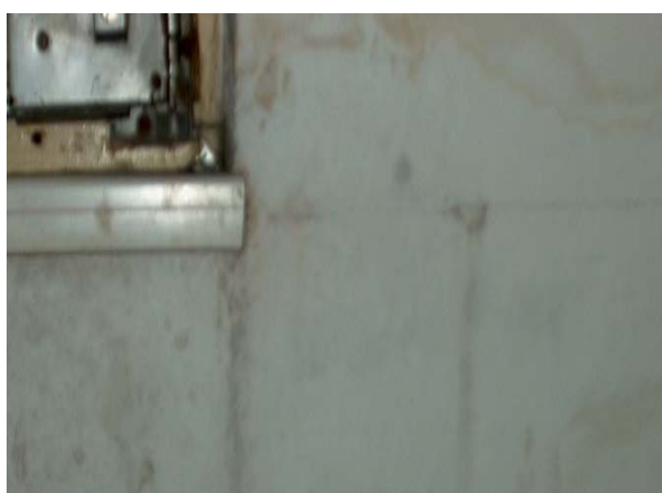
Obrázok 6: Trhliny v mieste stykov prvkov obvodového dielca na vnútornom povrchu s prejavmi zátekov zrážkovej vody
