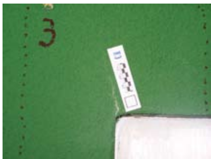
Obr. 1: Trhlina v rohu nadpražia okna v tmavej fasáde (vzniku trhliny nezabránila ani diagonálna mriežka).
