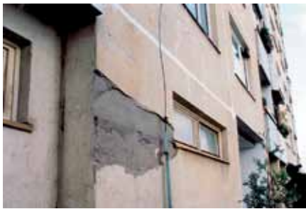
Obr. 7 Trhliny v obvodovom plášti T 08 B KE, Košice
