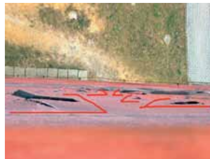
Obr. 11, 12 Degradácia povrchovej úpravy obvodového plášťa
