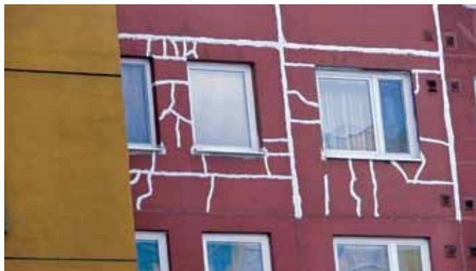
Obr. 3 Šikmé trhliny a trhliny v stykoch panelov P 1.15, Bratislava, Koprivnická ulica
