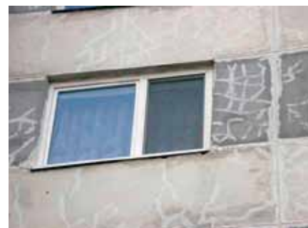
Obr. 6 Trhliny v obvodovom plášti T 06 B NA, Galanta
