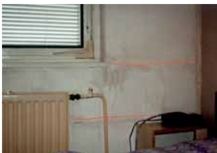
Obr. 10 Poruchy obvodového plášťa zistené na vnútornom povrchu
