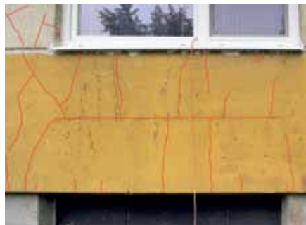
Obr. 1 Pohľad na obvodový plášť na báze pórobetónu porušený sieťou trhlin
