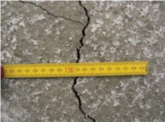
Typická divoká zmršťovacia trhlina
