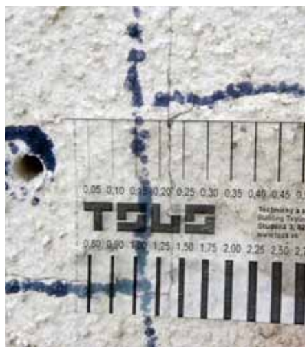
Obr. 2: Meranie šírky trhliny porovnávacou mierkou
