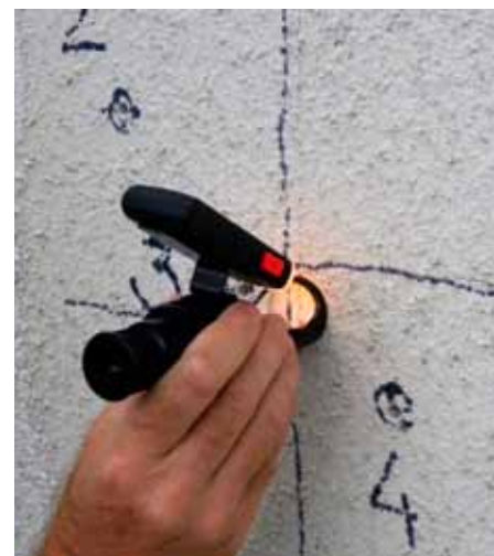
Obr. 3: Meranie šírky trhliny mikroskopom
