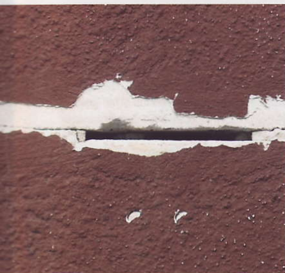
trhliná škára segmentov obvodového plášťa s drobiacou sa maltou
