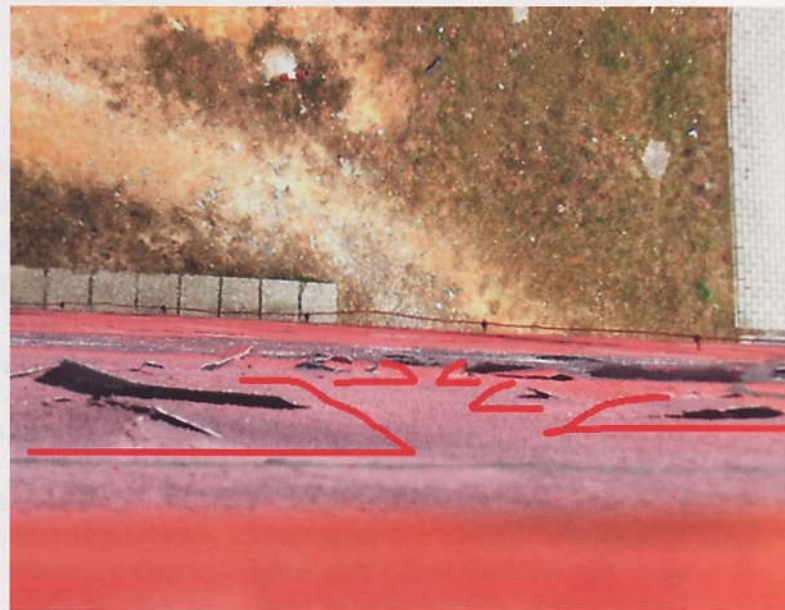
Degradácia povrchovej úpravy obvodového plášťa
