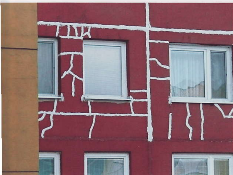
Šikmé trhliny a trhliny v stykoch panelov P 1.15, Bratislava, Koprivnická
