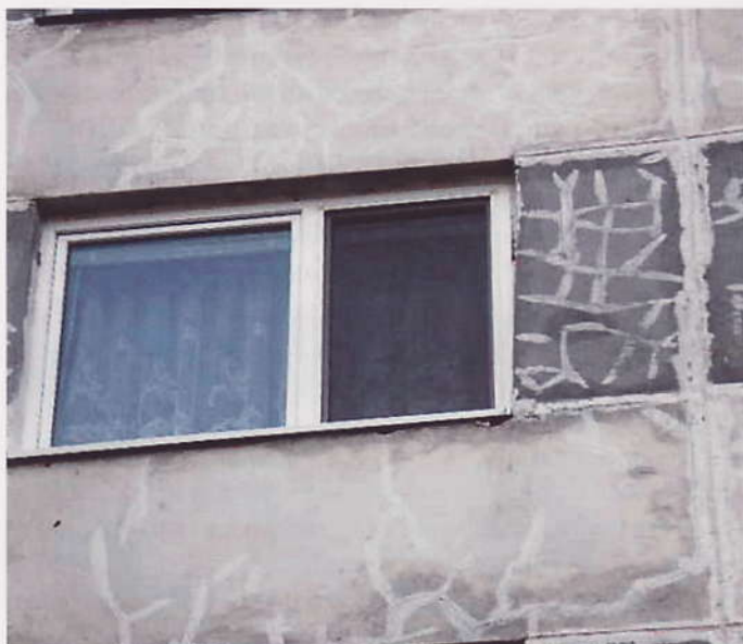
Trhliny v obvodovom plášti T 06B NA, Galanta
