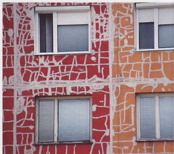
Vyplnené trhliny obvodového plášťa PS 82 TT, Trnava, Tehelná
