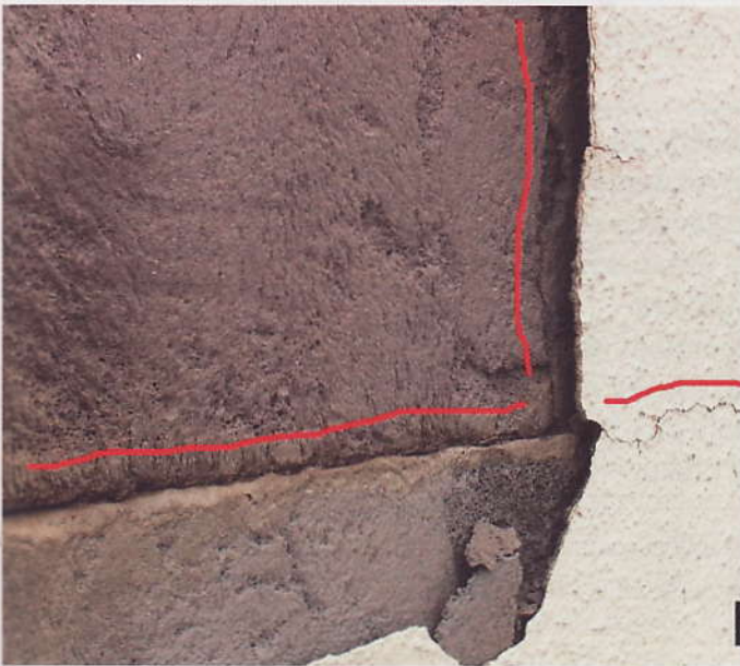
Degradácia povrchovej úpravy obvodového plášťa
