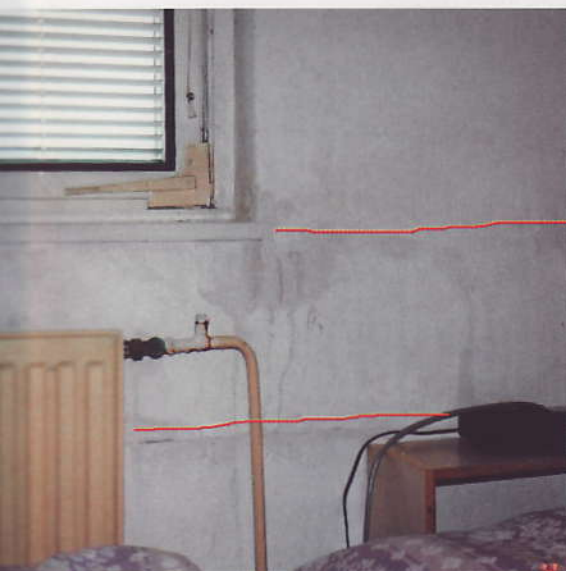
poruchy obvodového plášťa zistené na vnútornom povrchu
