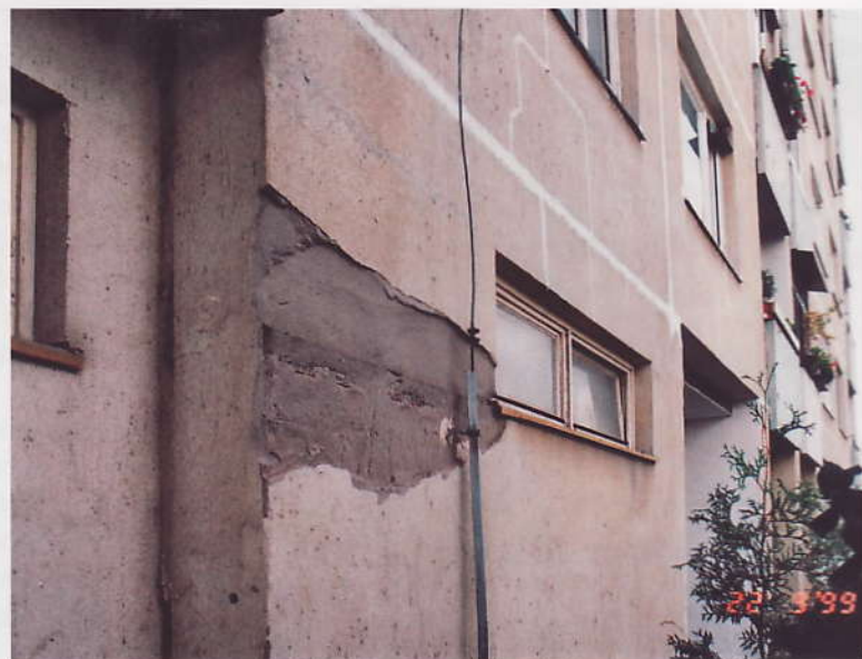
Trhliny v obvodovom plášti T 08B KE, Košice
