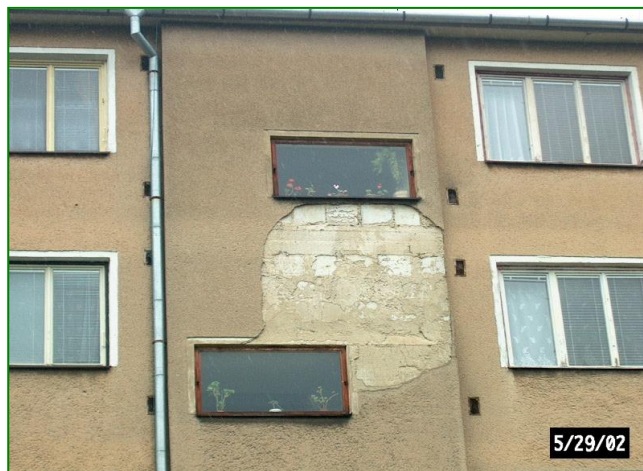
▲ Pohľad na zadnú fasádu – odpadávajúca omietka na schodisku View of the rear façade – fallen rendering at the staircase
