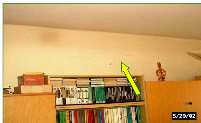
Trhliny a oddelenie vnútornej omietky od podkladu Cracks and separation of the inner rendering from the base
