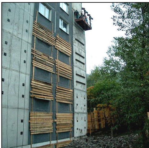
Klimaticky namáhaný náveterný štít počas odoberania obkladových panelov Climatic stressed gable wall during the taking off the facing panels
