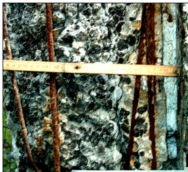
Korózia výstuže obkladového panelu po samovoľnom odpadnutí oddelenej hmoty keramzitbetónu Reinforce corrosion of facing panel after individual fall of "keramzit-concrete" mass
