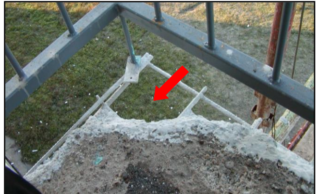
Chýbajúci prierez nosnej dosky balkóna v mieste kotvenia zábradlia, výstuž ošetrená antikorozióznym náterom Missing section of the bearing board at the anchorage of the railing, reinforcement treated with anticorrosive paint.
