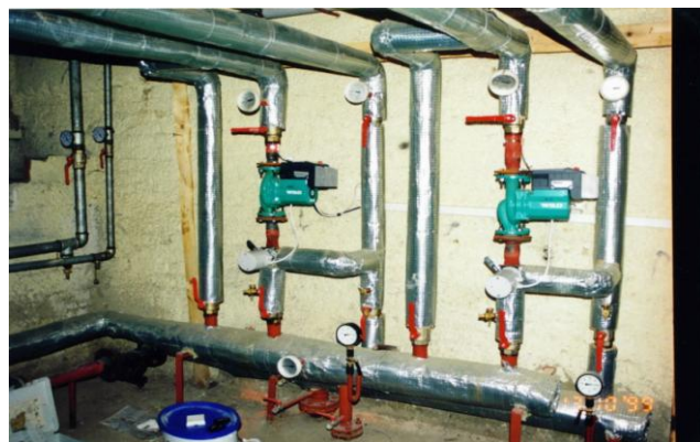
▲ Strojovňa výmenikovej stanice Machinery-room of the heat exchanger station
