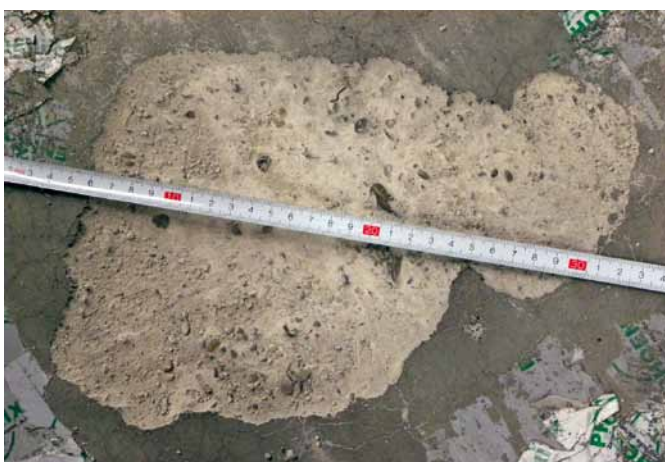
Obr. 10 Lokálna delaminácia nášľapnej vrstvy podlahy
