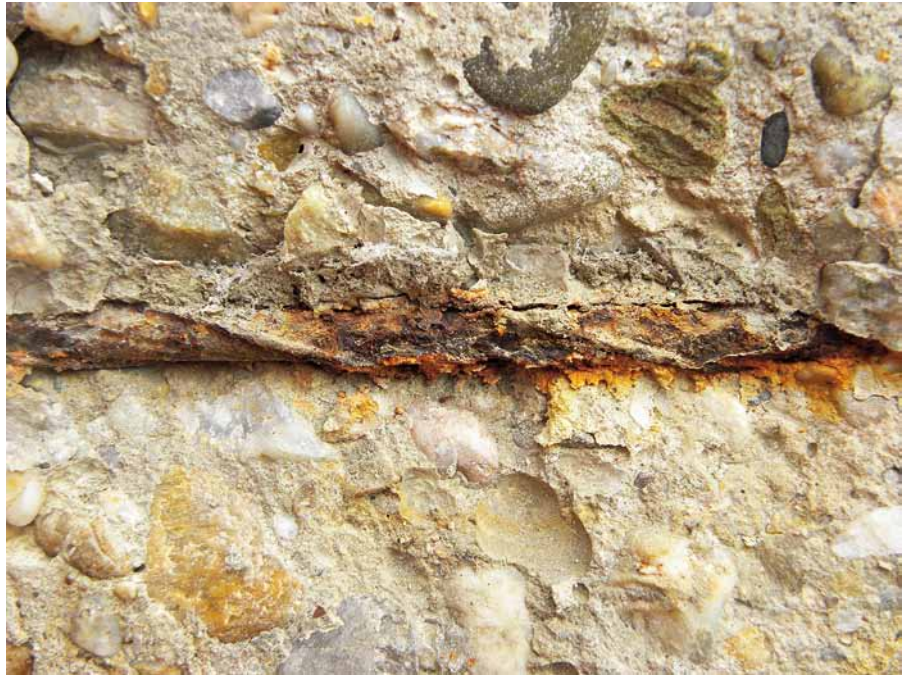
Obr. 3 Korodujúca ocelová výstuž (strmeň) stĺpa
