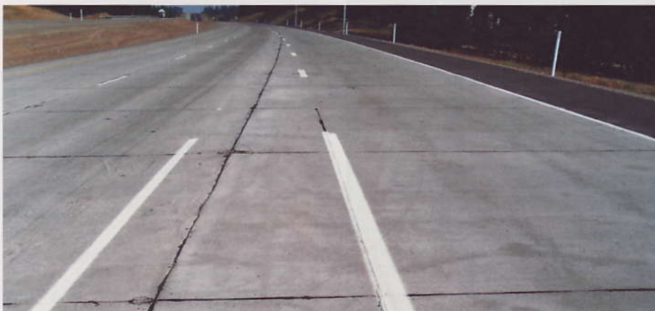
Obr. 1: Dilatačné a zároveň kontrakčné škáry vo vozovke
