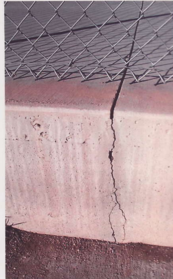
Obr. 7: Kontrakčná rezaná škára a vzniknutá trhlina
