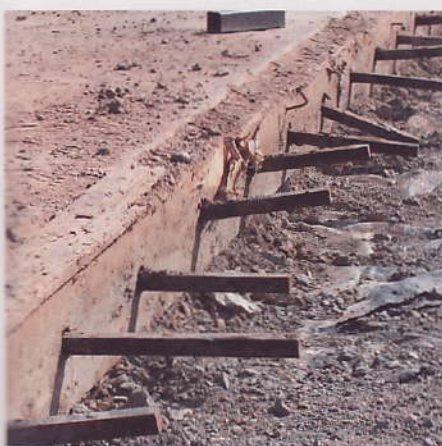
Obr. 14: Absolutne nevhodne pripravená klzná výstuž
